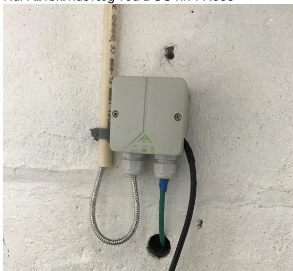
Foto 4 Hul i tørbrøndsvæg ved DGU nr. 77.958
